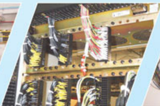
CABLAGGIO ELETTROMECCANICO PER TRASPORTO FERROVIARIO
